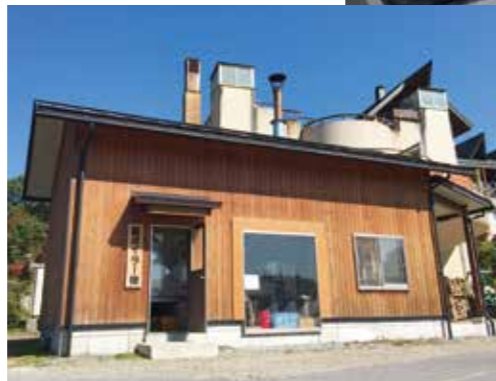
1日に7回程度行なわれる、薪ボイラーへの薪投入(上) 芸北オークガーデンの薪ボイラー棟(左)
