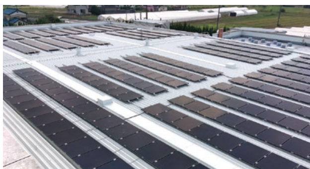
FFTP佐野サイト 太陽光発電設備
